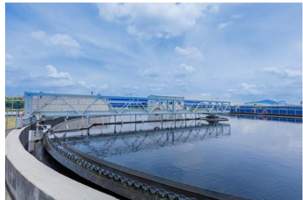
Hệ thống xử lý nước thải với công nghệ tiên tiến tại Nhà máy HEINEKEN VIỆT NAM (Vũng Tàu).
